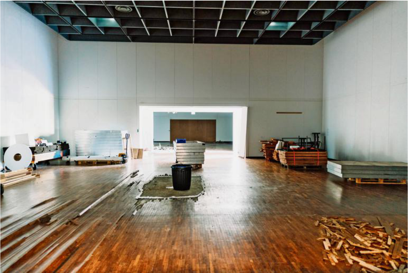
Le plancher d’une salle du Théâtre Jean-Lurçat, abîmé par l’eau, le 4 mars, à Aubusson (Creuse). MATHIEU FARCY/SIGNATURES POUR « LE MONDE »
