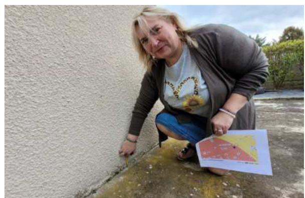
Saint-Laure (Puy-de-Dôme), lundi. Corinne Boiteux, dont la terrasse s'est affaissée, est éligible au financement du diagnostic.
